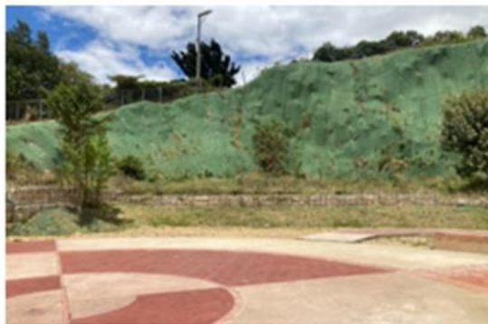
Obras de mitigación en Parque Mirador de los Nevados Fuente: DGA – grupo de infraestructura
