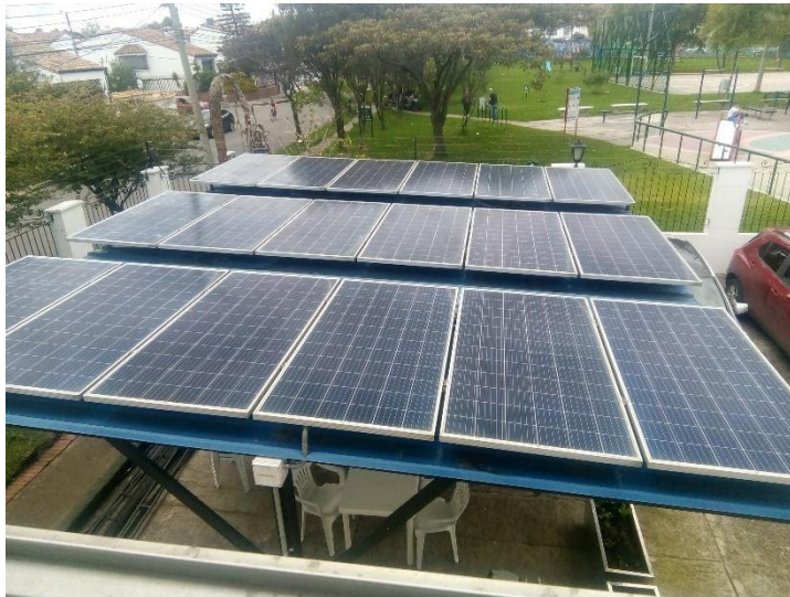
Sistema Solar instalado en alcaldía de Suba
