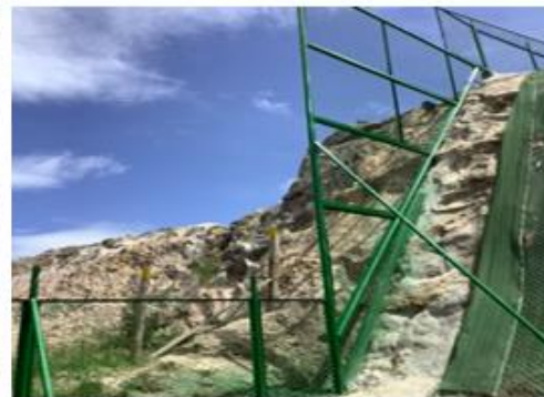
Malla de protección Aula Juan Rey costado oriental (talud) Fuente: DGA – grupo de infraestructura
