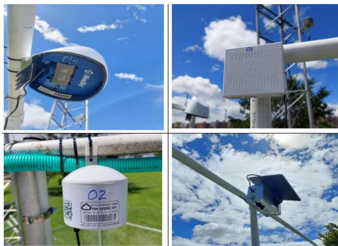
Ilustración 160: Detalle de los Microsensores y su instalación.
