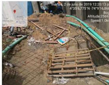
Fotografía No. 6. Evidencia por mal manejo de acopio de residuos en obra se realiza requerimiento. Proyecto Torres de San Rafael
