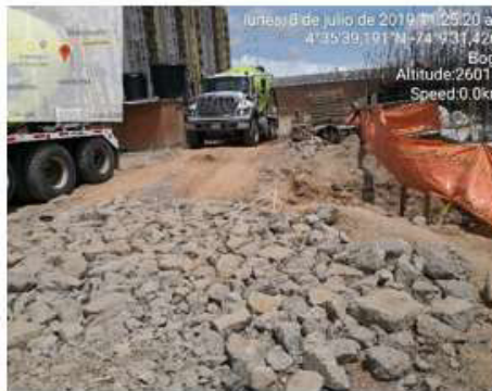
Fotografía No.5. Actividad nivelación de terreno con Aprovechamiento de RCD. Proyecto Reserva Madelena.
