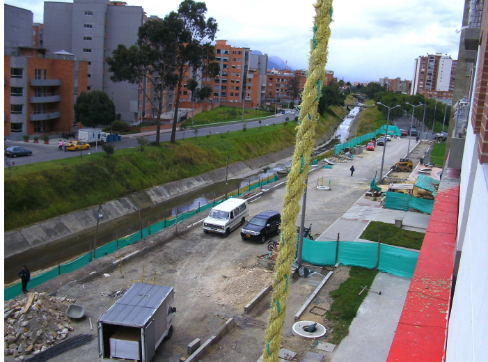
Foto 19. Frente de obra aledaño a un elemento de la EEP (norte de Bogotá)
