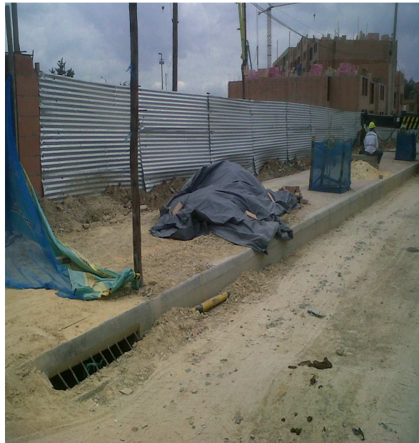
Foto 25. Práctica inadecuada: sumideros en espacio público sin protección
