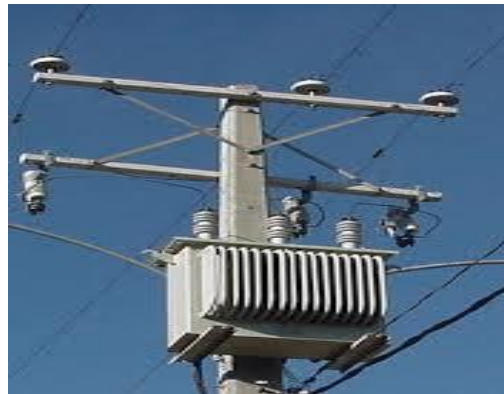
Fuente: www.eliminaciondepcb.cl –transformador eléctrico con PCB
