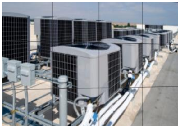
Fuente: http://www.ecosave.com.mx/ - sistema de refrigeración industrial con CFC
